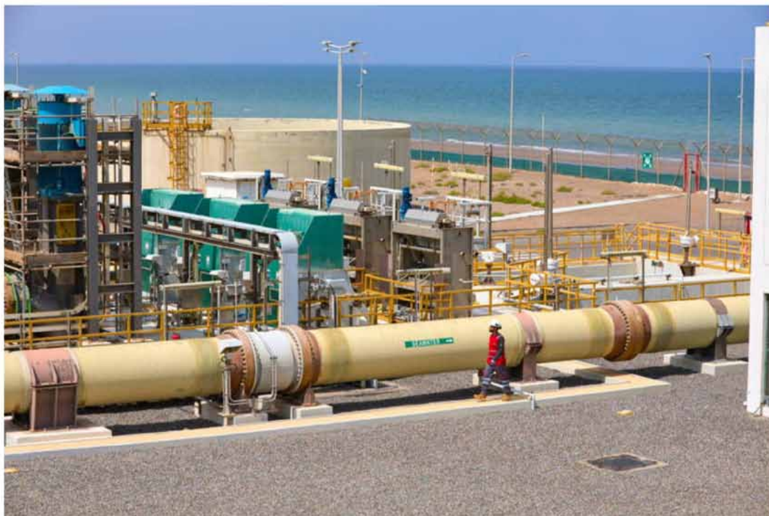
© CHRISTOPHE DAGUET/Veolia - L'usine de réutilisation des eaux usées au Qatar.
